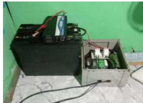
Gambar 9. Instalasi kelistrikan pembangkit hibrid
