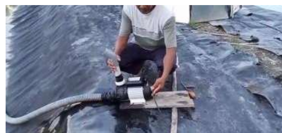
Gambar 10. Kondisi fisik pompa air
